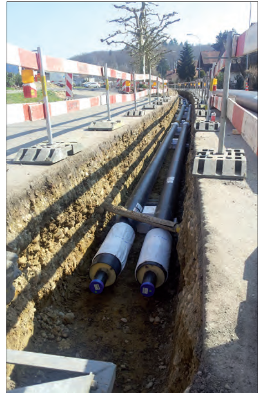
Fernwärmeleitungen aus isolierten Premant Stahlrohren, Vor- und Rücklauf werden getrennt verlegt. (Bild: ewk)
